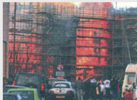
Fig. 1 - Recente incendio in una casa in costruzione di 7 piani in Edimburgo, dove pur con carico di incendio nullo, il fuoco ha attaccato la struttura in legno e l'incendio non ha potuto essere spento nonostante l'intervento di 80 pompieri, per cui sono andati distrutti tutti gli 82 appartamenti e la gru a torre.
