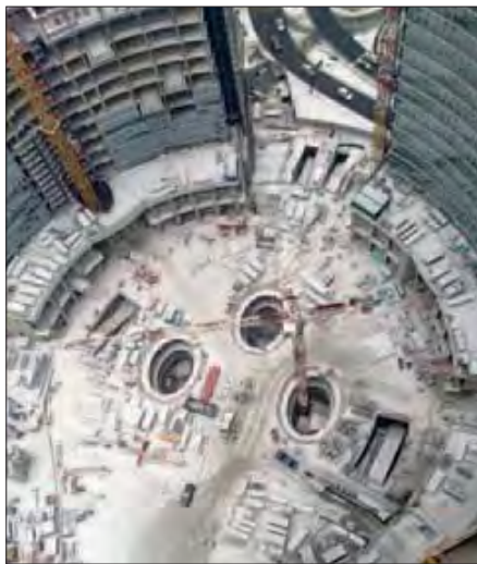
Vista zenitale del podio tra le Torri (imbiancato da una nevicata) le cui strutture sono ad oggi completate. A sinistra è visibile la Torre C su cui si stanno installando le facciate mentre a destra la Torre B le cui facciate sono state completate.
