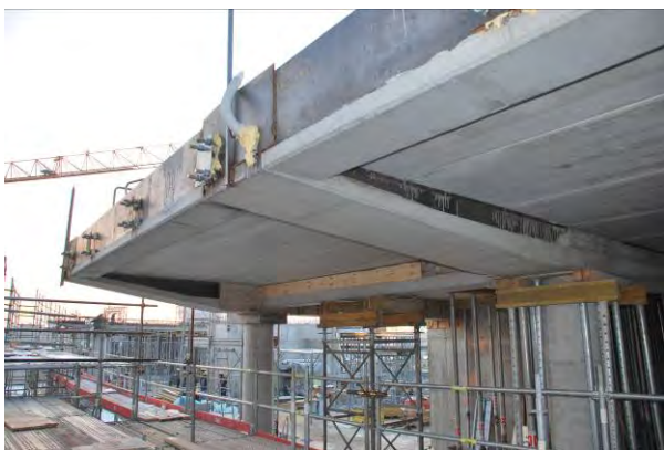
Figura 25. Vista intradosso elementi PREM con rastremazione della sezione: solaio di copertura, L5 (+155.50)
