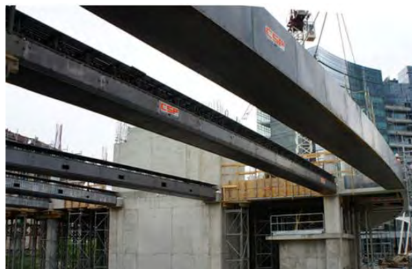
Figura 27. Zona collegamento E1-E2: travi PREM autoportanti con fondello e sponde in lamierino
